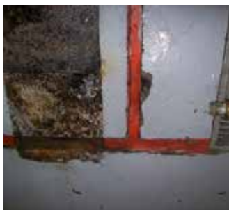
Szczelina w złym stanie
