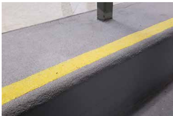
Belzona 4411 — zbliżenie fragmentu po ponad roku eksploatacji
