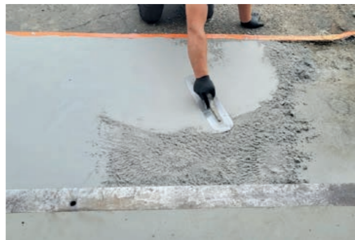
Fot.4c. Modernizacja podłogi w obrębie bramy wjazdowej do hali przemysłowej-nakładanie kompozytu Belzona®4111.
