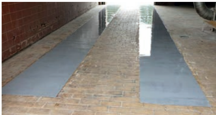
Fot.9b. Wzmocnienie podłogi kompozytem Belzona®4111 w miejscu częstych spękań i wycierania wywołanych ruchem pojazdów
