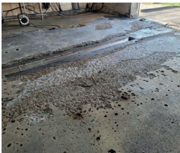
Fot.8a. Zniszczona taca rozładunkowa myjni system
