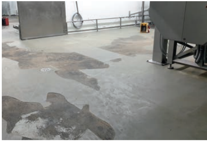
Fot.3. Delaminacja warstwy wierzchniej posadzki betonowej
