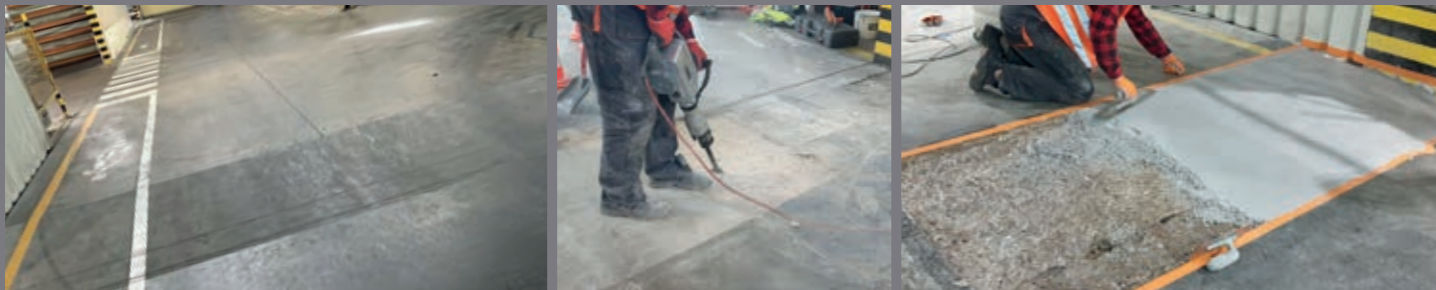
Nierówności w posadzce to nie wyrok!
