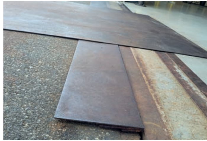
Fot.4a. Uskok progu wyjazdowego względem zewnętrznego placu manewrowego. Widoczny brak spójności pomiędzy stalowymi kątownikami a betonem i asfaltem
