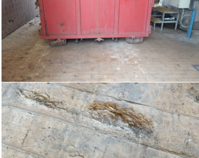
Fot.9a. Uszkodzenia w podłodze wywołane ruchem kółek metalowych
