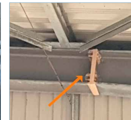
Fot. 6. Membrana Belzona®3412 jako zabezpieczenie przeciwkorozyjne połączenia doczołowego śrubowego konstrukcji hali suszarni osadów w oczyszczalni ścieków
