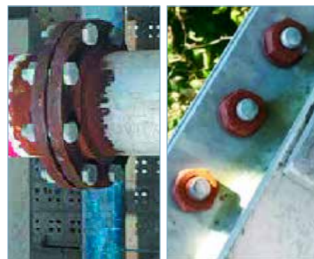
Fot. 1. Korozja elektrochemiczna
