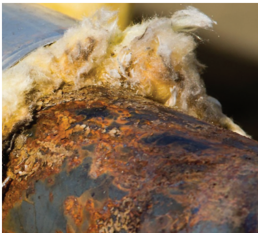
Korozja powierzchni rury pod izolacją cieplną (CUI)
