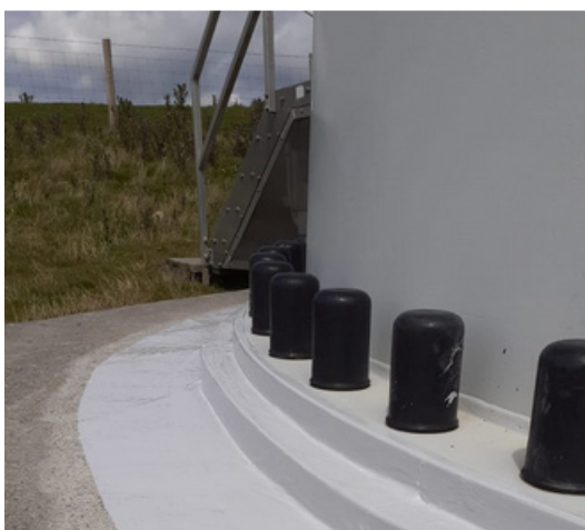
Zabezpieczenie kotwienia i fundamentu wieży turbiny wiatrowej
