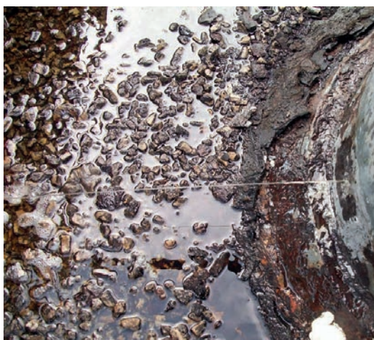
Korozja i wyciek oleju z wieży transformatora niskiego napięcia
