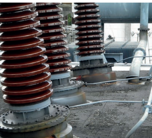
Nieszczelność połączeń kotłowniczych i śrubowych podstacji elektrycznej
