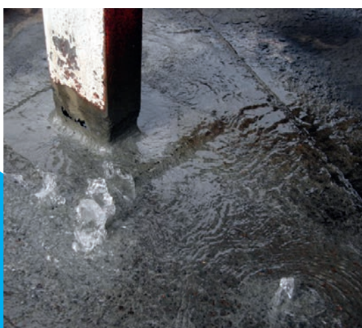
Nieszczelność pokrywy zbiornika powstała w wyniku korozji
