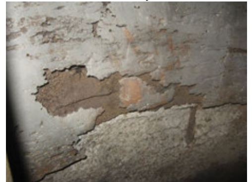
widok uszkodzeń powierzchni betonowej i pierścienia stalowego
