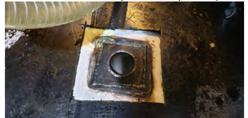
miejsce naprawy przed przygotowaniem powierzchni
