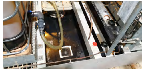
Taca stalowa przed naprawą
